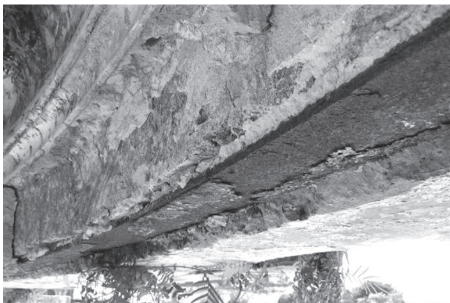
Figura 3. Acción de la corrosión sobre perfiles estructurales. Fuente propia.
