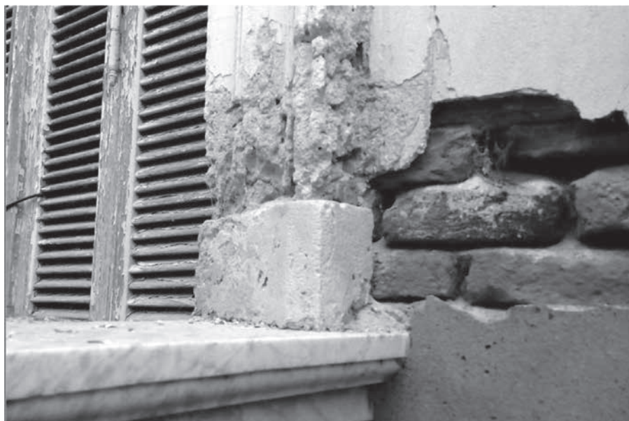
Figura 5. Degradación de los morteros. Fuente propia.
