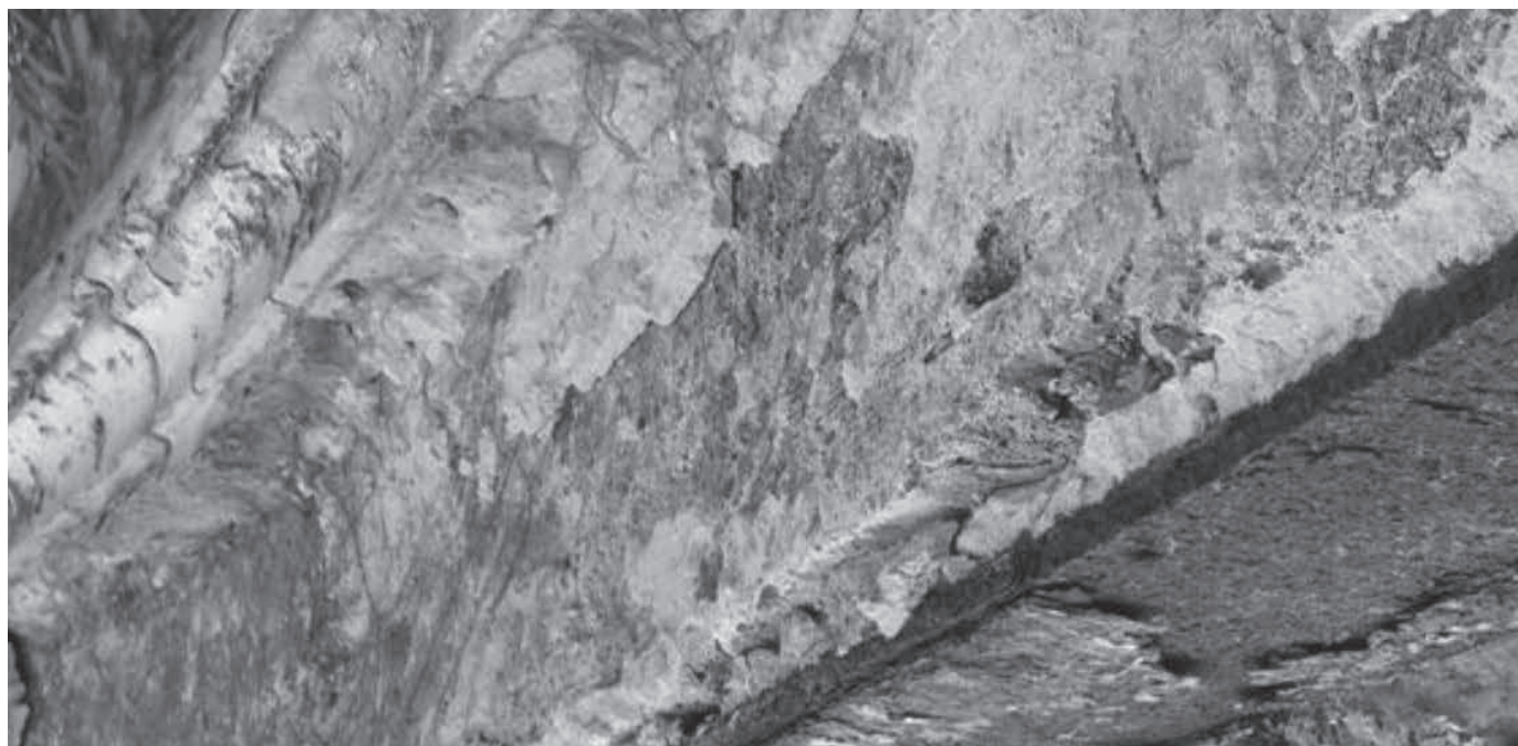
Detalle degradación de los morteros.
