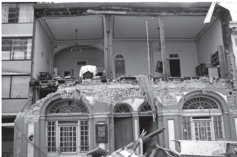
Figura 3. Casa en calle San Martín entre Aníbal Pinto y Colo Colo, Concepción, luego del terremoto del 27 de febrero del 2010. Foto: Carola Maturana.
