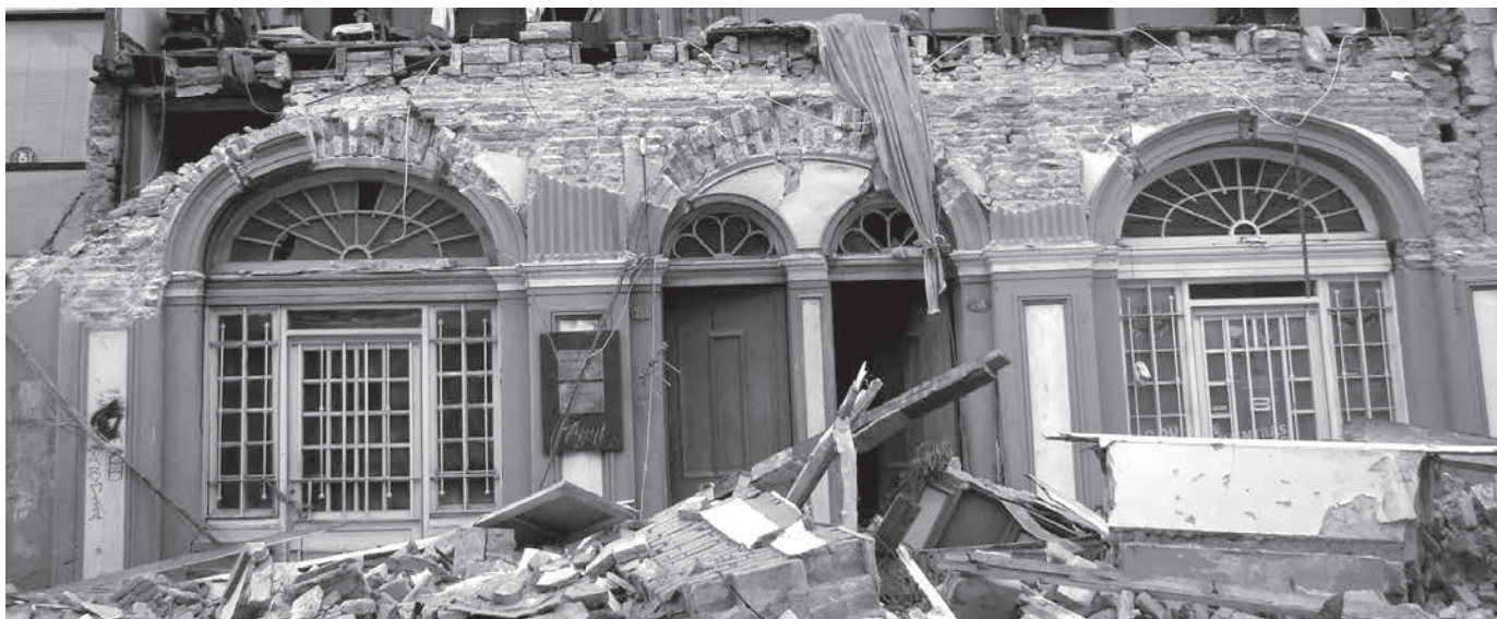
Detalle figura 3. Casa en calle San Martín entre Aníbal Pinto y Colo Colo, Concepción, luego del terremoto del 27 de febrero del 2010.
