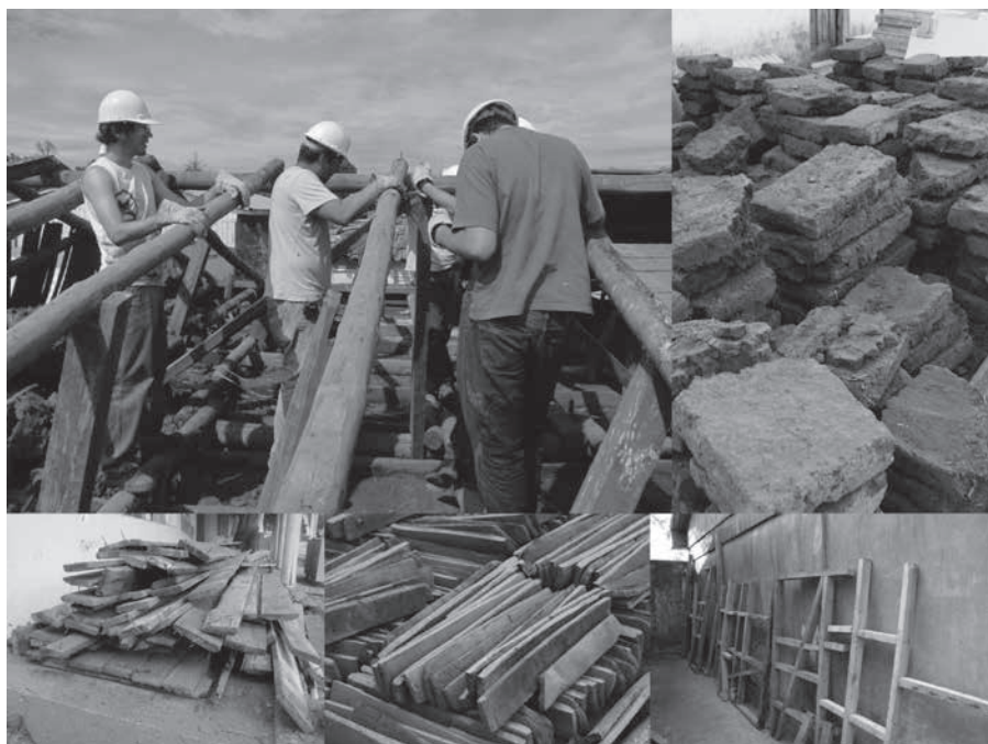
Figura 4. Desmantelamiento y clasificación de materiales en una casa por demoler en la Zona Típica de Chanco. Fotografías: Carmen Gómez Maestro.
