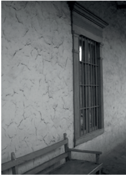
Estado actual de deterioro
