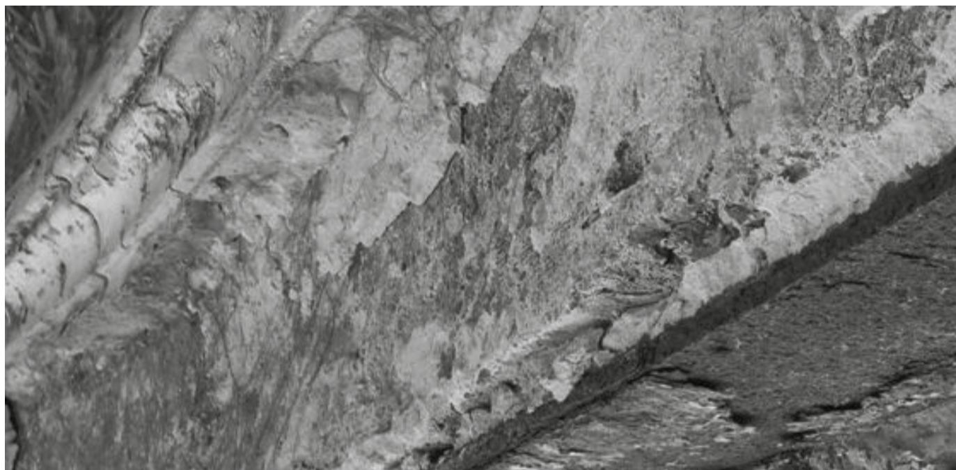
Detalle degradación de los morteros.
