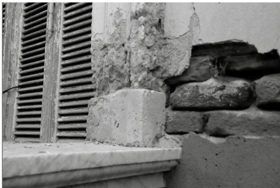
Figura 5. Degradación de los morteros. Fuente propia.
